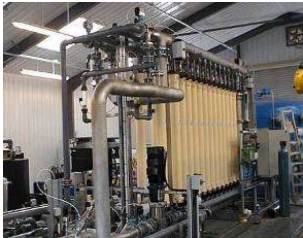
Нетиповая система ARIA для очистки 64,5 м 3 /ч вторичных стоков водопроводной станции (г. Питерборо, Великобритания)
