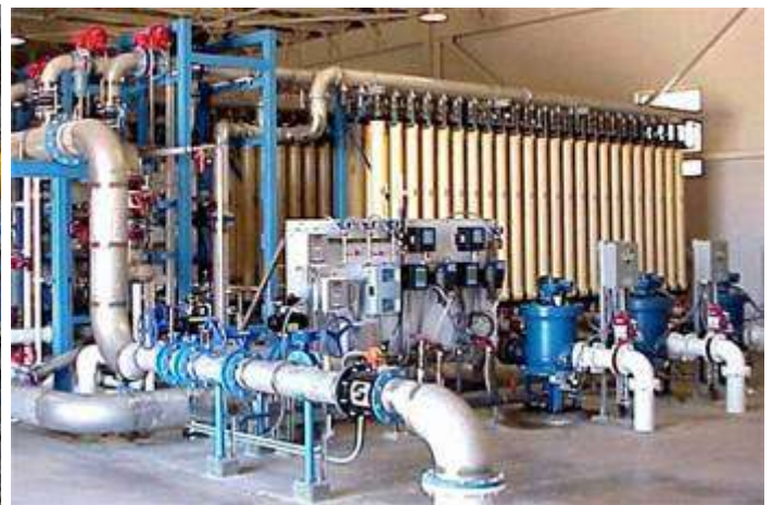
Нетиповая система ARIA для очистки 315 м 3 /ч вторичных стоков водопроводной станции (г. Фаунтейн Хилл, США)
